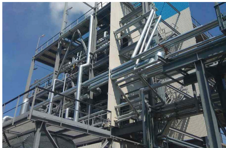
Установка производства раствора карбамида 32,5%. На ее базе будет размещена установка КАС
