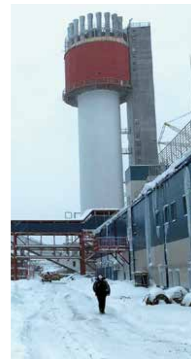
Гранбашня комплекса АКМ на ПАО «Метафракс»
