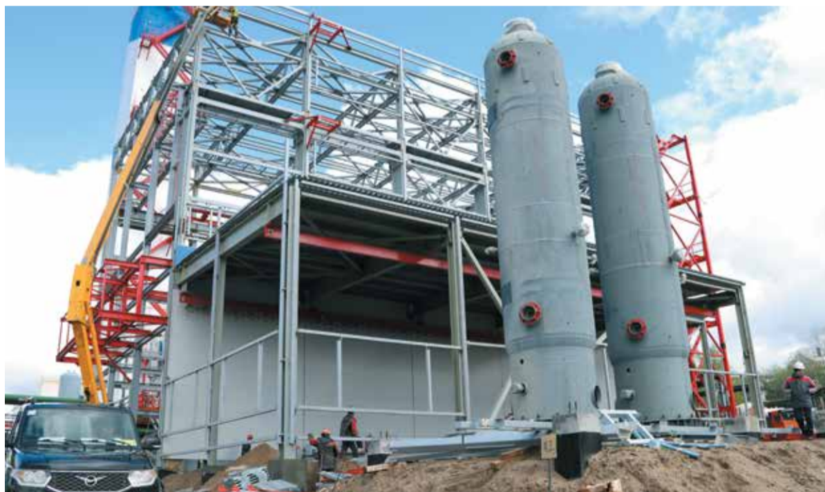
Корпус 180б, компрессия воздуха КИП
