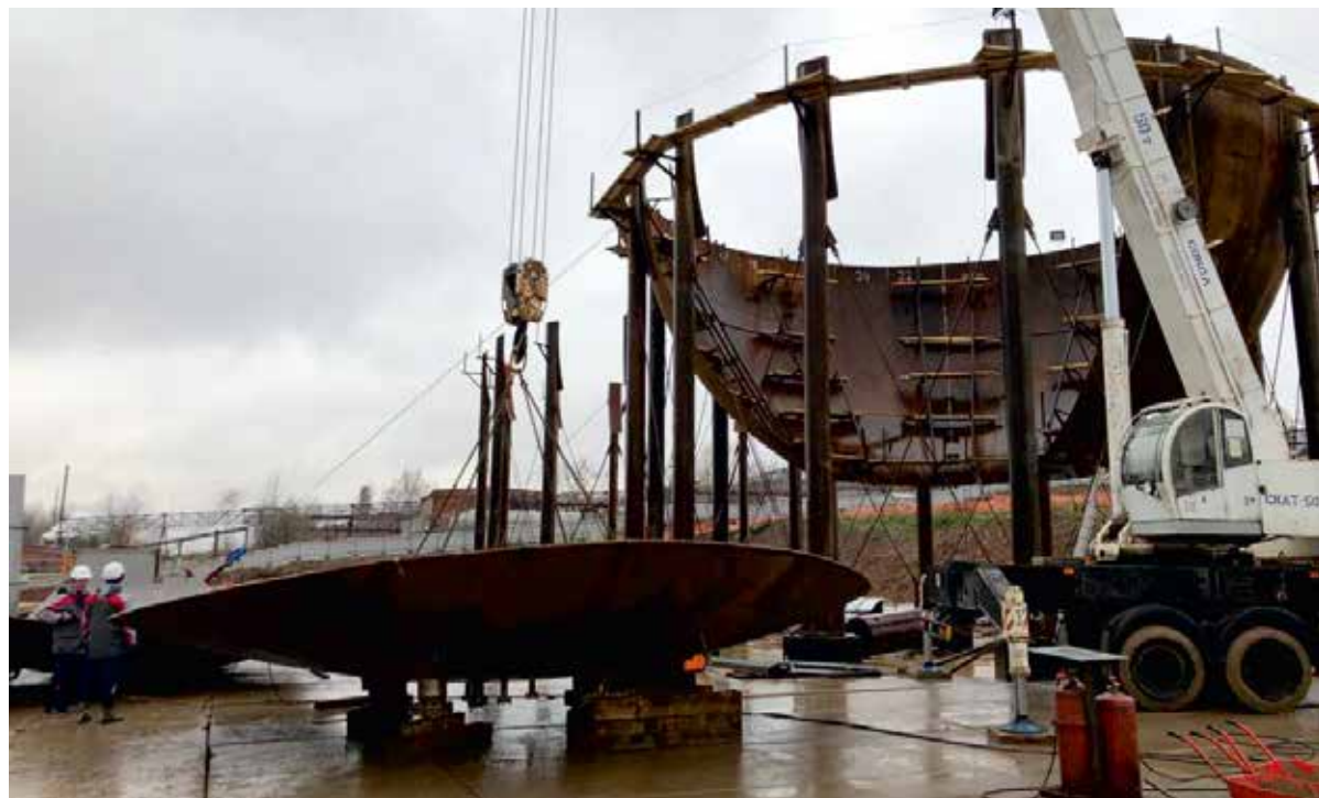
Шаровой резервуар жидкого аммиака под давлением
