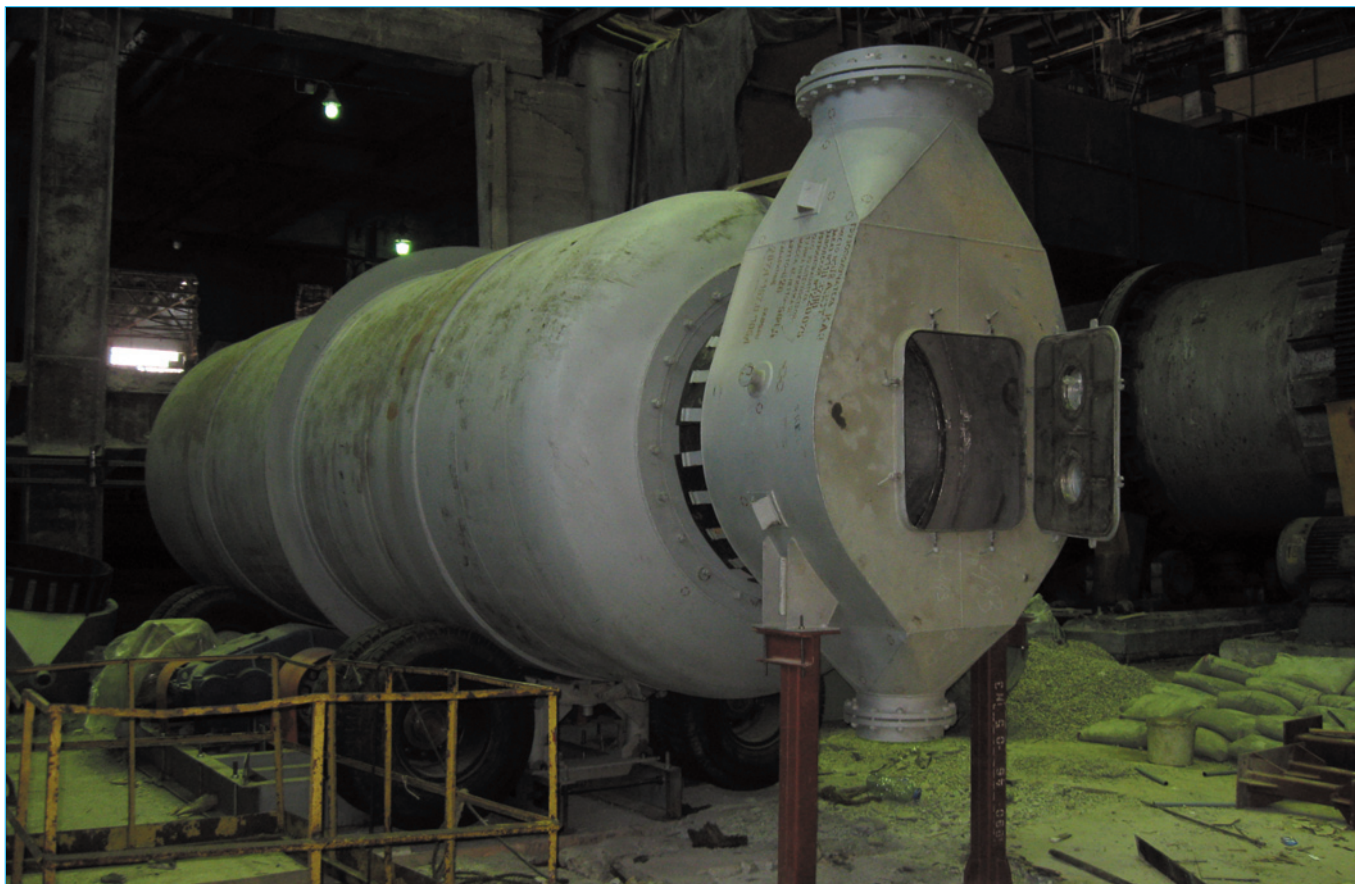
Рис. 5. Установка гранулирования аммиачной селитры на ТОО «КазАзот», г. Актау, Казахстан
