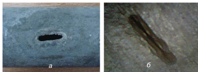
Рис. 3. Дефекты трубы, заглушенной на ПСК: а – сквозной дефект 1; б – близкий к сквозному дефект 2
