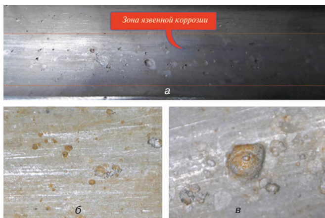
Рис. 1. Внутренняя поверхность трубы: а, в – зона язвенной коррозии; б – зона питтинговой коррозии
