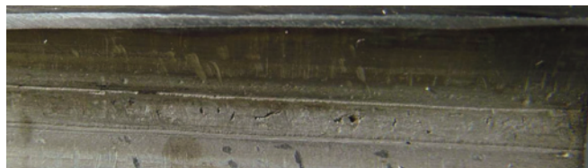
Рис. 5. Внутренняя поверхность трубы, отбракованной по результатам ВТК
