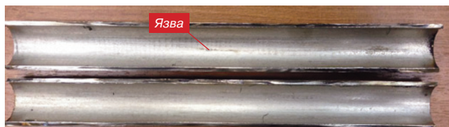
Рис. 7. Состояние внутренней поверхности участка трубы с повышенным шумом
