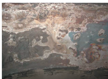
Рис. 6. Коррозия футеровки под накладками
